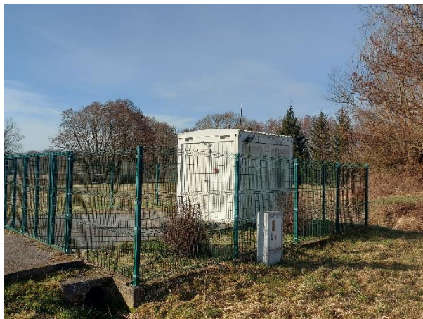
Slika 16.: Precrpna stanica Donja Rijeka Izvor: Zavod za prostorno uređenje Koprivničko-križevačke županije, 21.02.2024.
