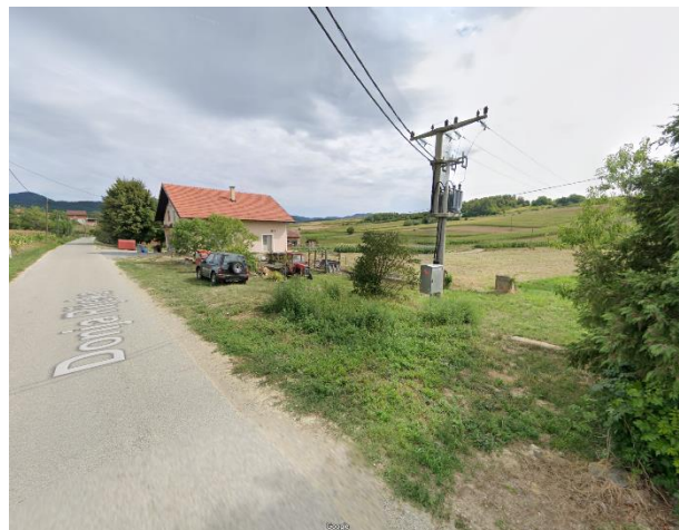
Slika 10.: Novoizgrađena trafostanica Gornja Rijeka II
